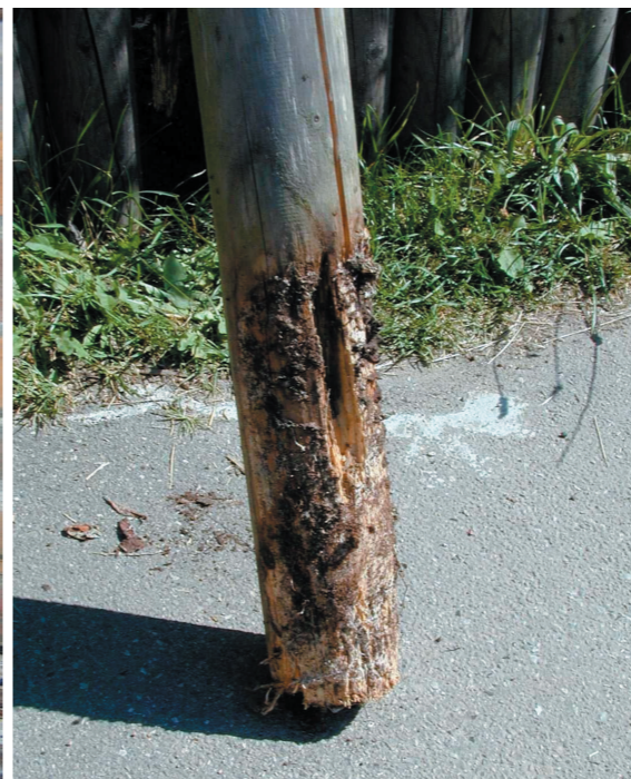
Ubehandlet lærketræsstolpe - efter 4 år i jordkontakt er den kraftigt nedbrudt.
